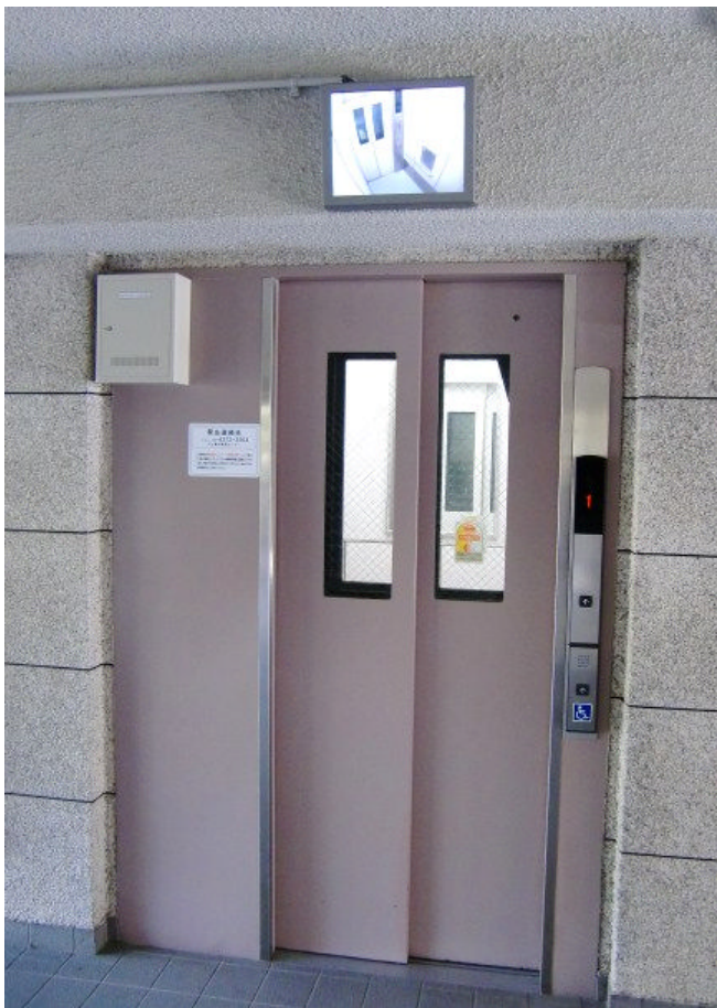
1階エレベーターホール エレベータードア
