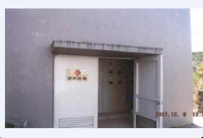
施工前 扉にガラクチあり
