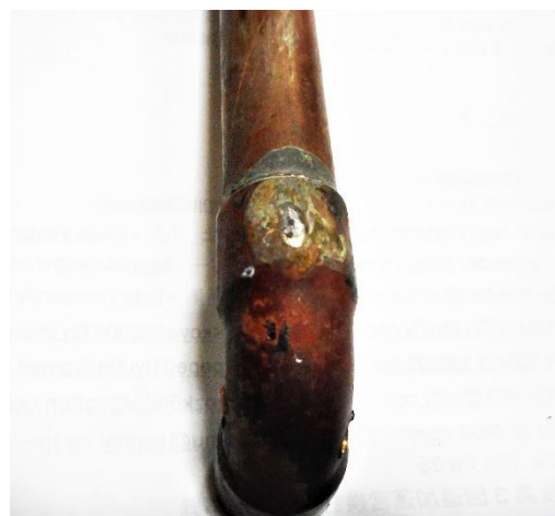
ピンホールの出来た銅製給湯管
